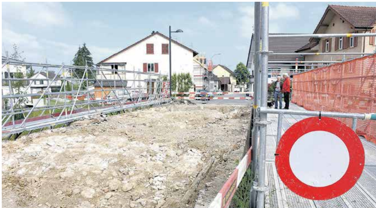
Die Sanierung der Surbbrücke ist in Gang und historisch Interessierte, wie Hans Zimmermann und Louis Tiefenauer, betrachten die Baustelle.
