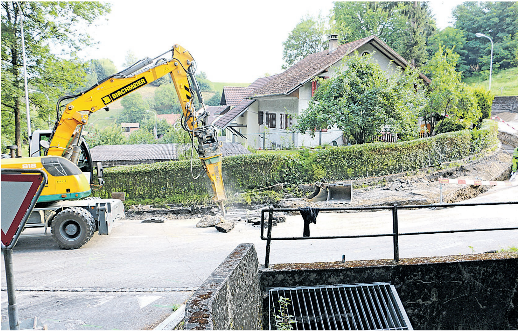
In der Granella-Kurve entfernt der Bagger den alten Bachdurchlass. Die neue Röhre wird unter der Einmündung der Steinenbühlstrasse (links) angeschlossen.
